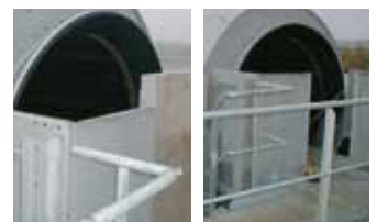
Zugangspodest für Wartungsarbeiten im Inneren der Trommel (z. B. an der Verkleidung).
